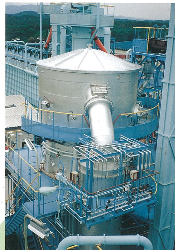
流動床式産業廃棄物焼却施設
