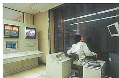
〈クレーン操作室〉
