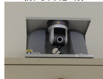
防災センター側 (カメラ、スピーカ)
