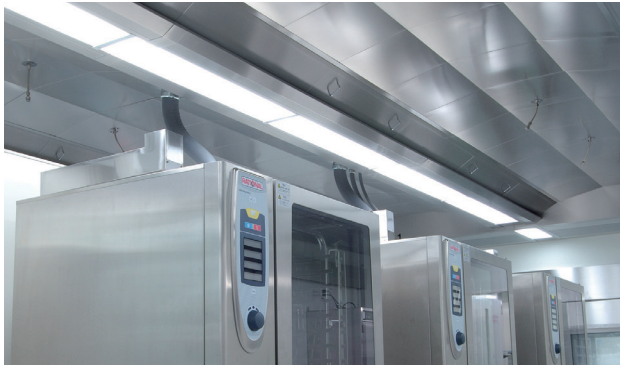
見通しのよい天井換気システムとスチームコンベクションオープン
