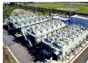
下水の高度処理施設
