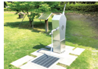
三機テクノセンターに設置した「災害時用井戸」
