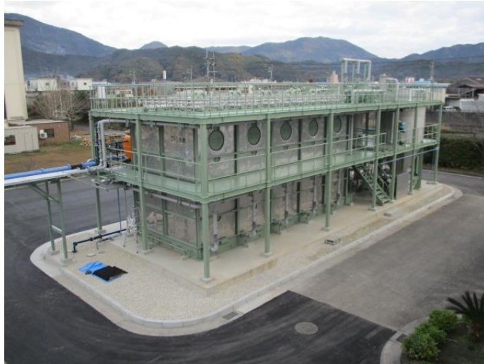
写真1 実証施設の外観（左：DHSろ床、右：生物膜ろ過槽）
