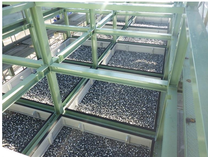
写真2 DHSろ床内部（担体充填後の状況）
