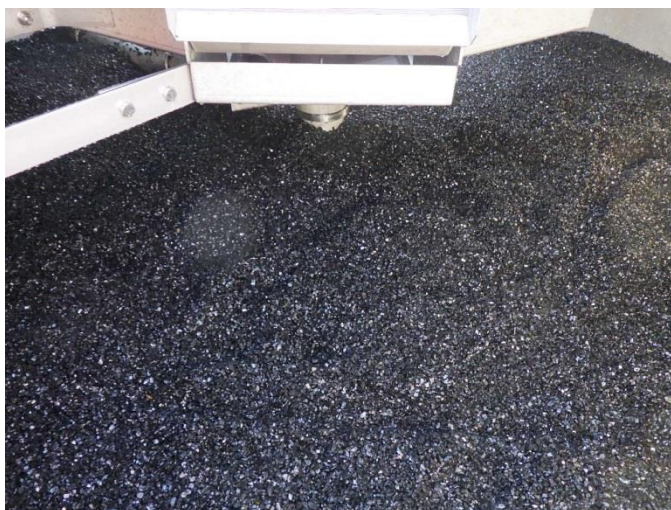
写真3 生物膜ろ過槽内部（担体充填後の状況）
