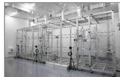
低露点ブース外観
