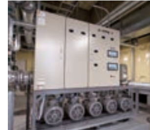
▲受水槽機械室
