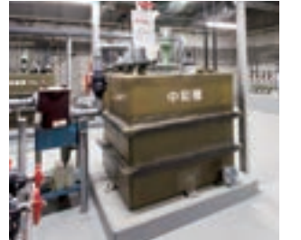
▲排水処理設備
