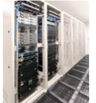
▲サーバールーム
