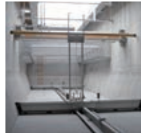
▲モノレール式污泥掻寄機
