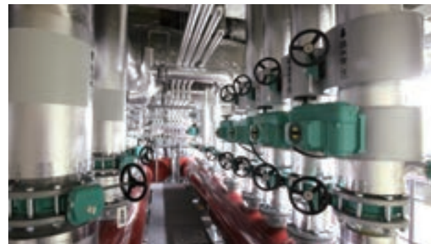
▲ヘッダー周りの配管
