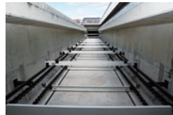
▲チェーンフライト式汚泥掻寄機
