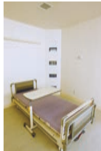
▲臭気排気設備
