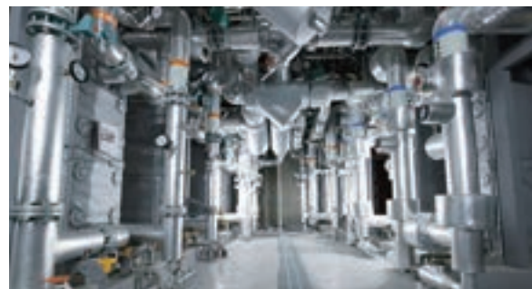
▲保守点検のために熱交換器につながるポンプと配管を2系統ずつ設けた設備構成
