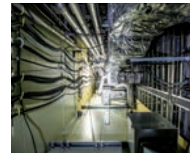
▲天井内の配管類
