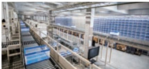
▲自動倉庫設備
