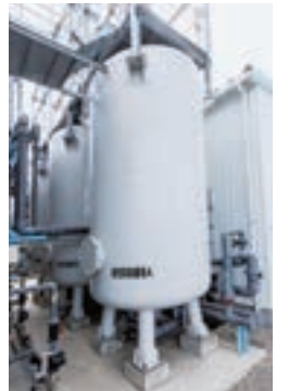
▲COD除去を行う活性炭吸着塔
