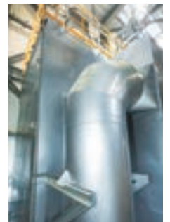
▲ろ過式集塵機
