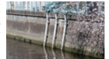
▲施設から300mほど下流にある取水設備
